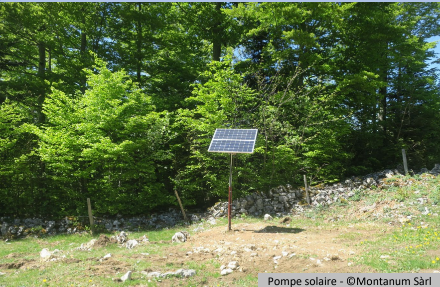
Pompe solaire - ©Montanum Sàrl
