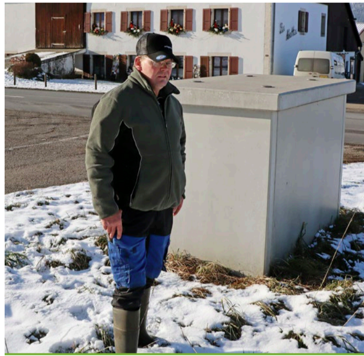
Pierre-Yves Nicolet devant le transformateur de séparation.
